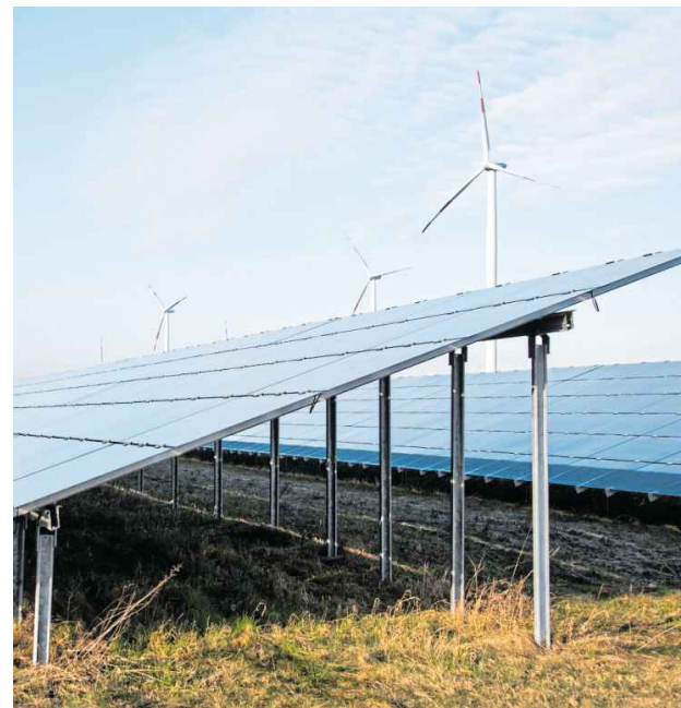
Eine Freiflächen-Photovoltaik-Anlage: Die Solar-Paneele werden auf einem Metallgestell angebracht. Ähnlich wird es auch in Hiddenhausen aussehen.
